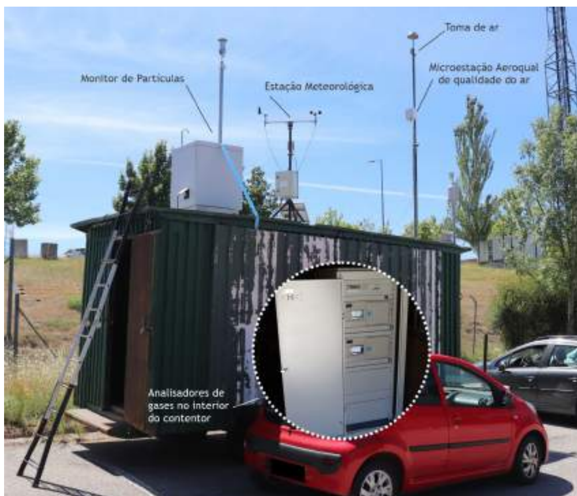
Fig. 36- Apresentação da estrutura instalada para a monitorização de la qualidade do ar e parâmetros meteorológicos. Na imagem são identificados os principais componentes utilizados no estudo.
